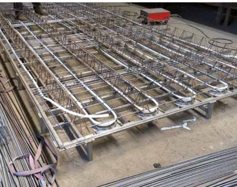
Schablone zur präzisen Herstellung der Rohrregister und deren Befestigung an der Bewehrung.
